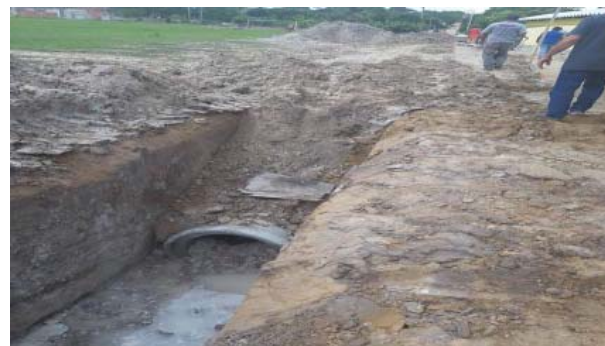
Figura 1 - Reaterro sendo executado com o próprio material da escavação e sem compactação adequada
