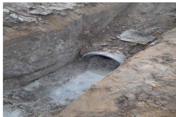
Figura 2 – Manilha sem o embasamento
