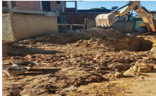
Figura 2 – Reaterro sendo executado com o próprio material da escavação e sem compactação adequada
