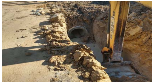
Figura 3 – Manilha sem o embasamento
