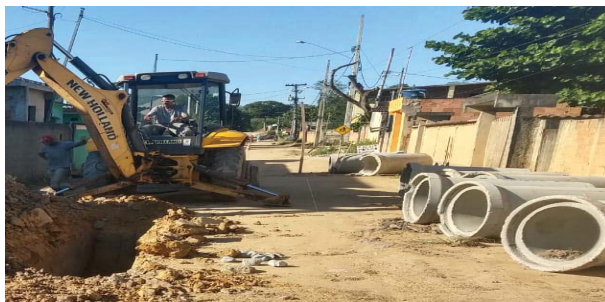
Figura 1 – Não utilização de cercar de proteção de vala
